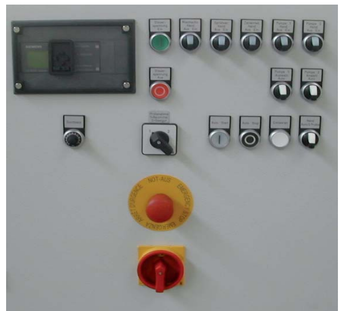
Schaltschrank mit Logo-Steuerung, Serienausrüstung
